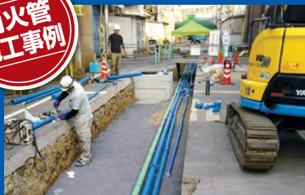
工場埋設消火配管
