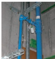
パイプシャフト内
