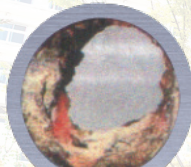
錆びた金属管の内部
