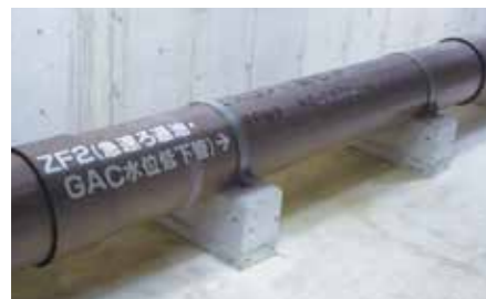
φ500大阪府浄水場内配管 コンクリートサドル+鋼製バンドで固定
