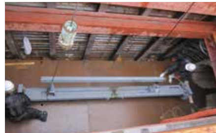
φ1000山口県工業用水道配水管 管路更生 カゴ型台車の吊り降ろし
