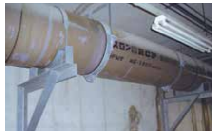
φ500大阪府浄水場内配管 支持金具で吊配管
