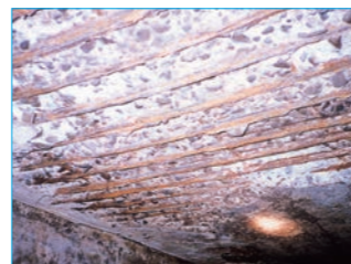
● 既設管の腐食状況(矩形)
