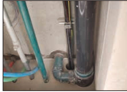
パイプシャフト配管
