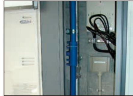
パイプシャフト配管
