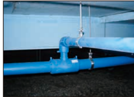
ピット内配管
