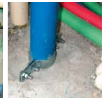
床バンドコンクリート埋設による固定 支持 (コンクリート増し打ち前)
