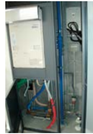
パイプシャフト内
