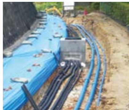
神社参詣道屋外消火栓の埋設配管
