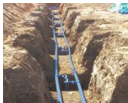
横引き管と分岐部
