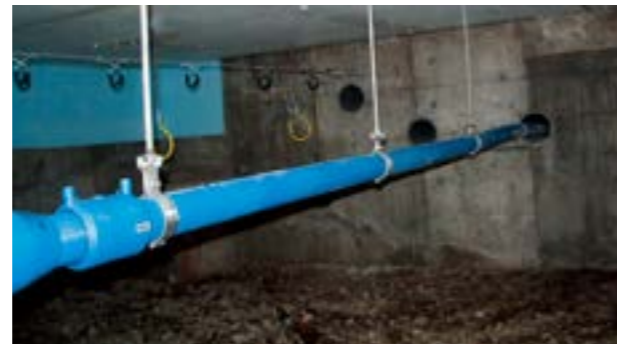
スリーブ貫通箇所付近(熱伸縮でたわみが発生する場合があります。)
