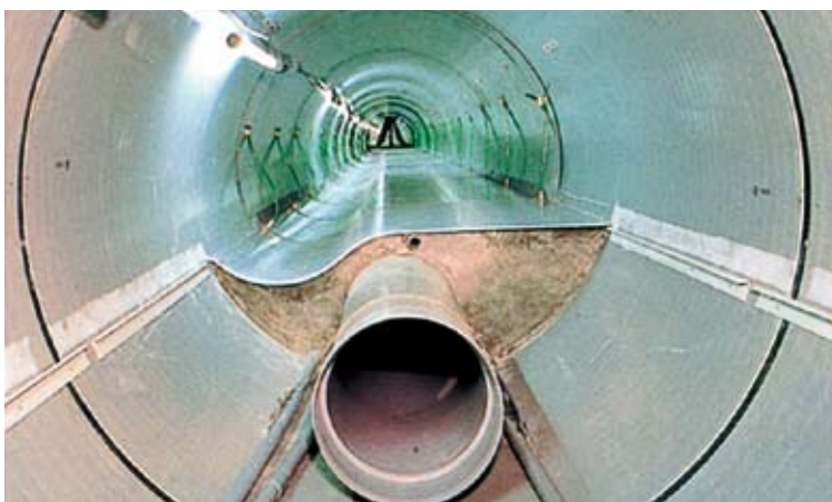
■多機能二次覆工例 (シールド内配管φ600・φ2400)
