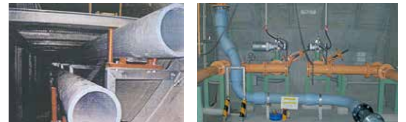
シールド内に設置された汚泥圧送管 処理場施設内に設置された汚泥配管
