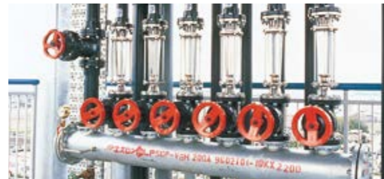
定常流排水 途中階に設けられたヘッダーより流量計を通して、各階へ定常流排水を行うことができます。
