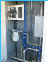
パイプシャフト内の配管
