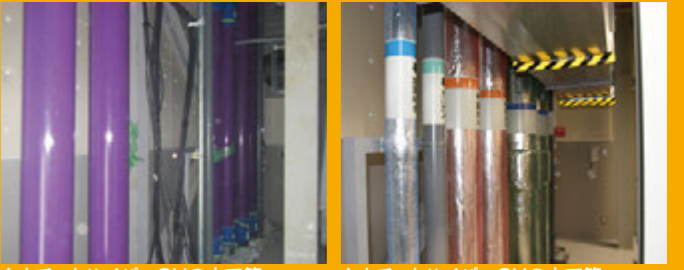
クウチョウハイパーCHの立て管(保温材巻き付け前) クウチョウハイパーCHの立て管(保温材巻き付け後)
