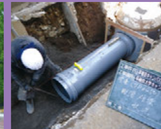
早稲田大学ではハード面管理の一つとして災害用マンホールトイレを設置
