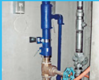
給水立て管に採用されたエスロハイパー-AW
