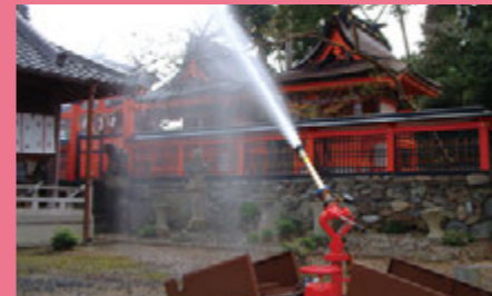
丹生官省符神社防災施設消火設備
