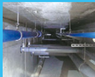
ビット内の配管
