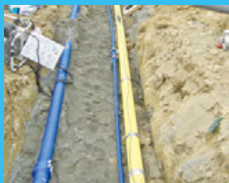
青=エスロハイパー-AW(敷地内埋設配管) 黄=エスロンガス用ポリエチレン管
