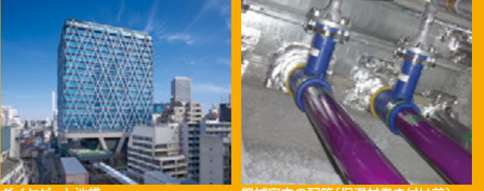
ダイアゲート池袋 機械室内の配管(保温材巻き付け前)
