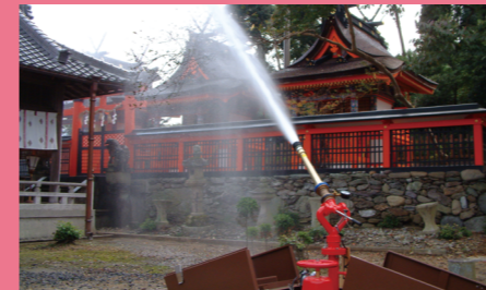
丹生官省符神社防災施設消火設備
