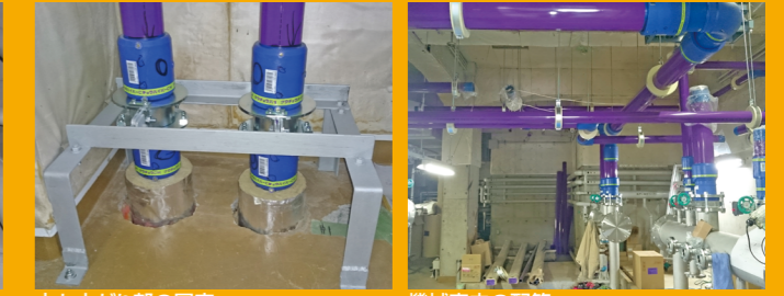
立ち上がり部の固定 機械室内の配管
