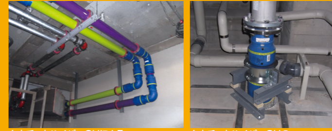
クウチョウハイパーCHによる2管式冷温水配管(保温前の写真) クウチョウハイパーCHの立て管支持部
