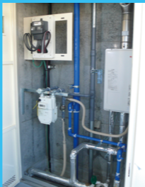
パイプシャフト内の配管
