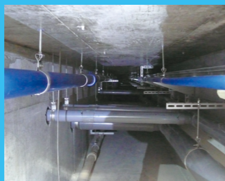
ピット内の配管
