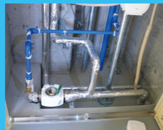
メーター回りの配管と、かんたんクランプ
