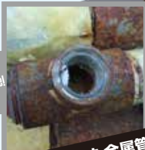
老朽化した金属管
