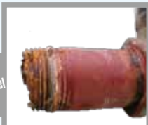
老朽化した金属管
