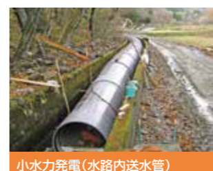
小水力発電(水路内送水管)
