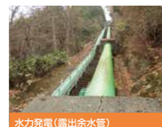
水力発電(露出余水管)
