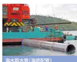
海水取水管(海底配管)
