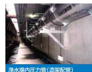
浄水場内圧力管(添架配管)
