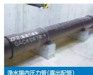
浄水場内圧力管(露出配管)
