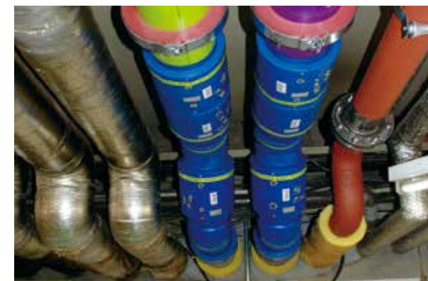
天井内配管 (2色の管の使用による誤接続防止)
