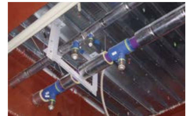
天井内配管 (ネジで分岐)
