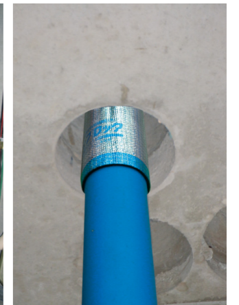
防火区画貫通部
