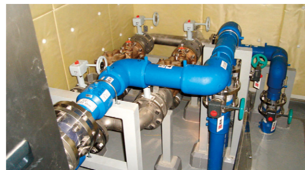
増圧ポンプ廻り
