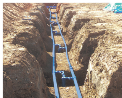
横引き管と分岐部
