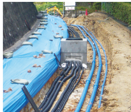
神社参詣道屋外消火栓の埋設配管
