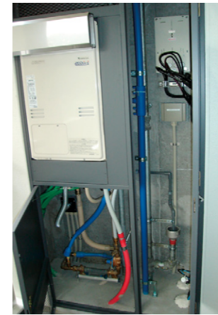
パイプシャフト内
