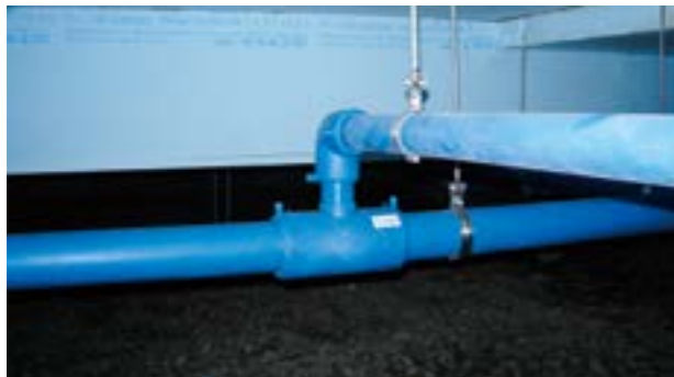
チーズ分岐付近(熱伸縮でたわみが発生する場合があります。)
