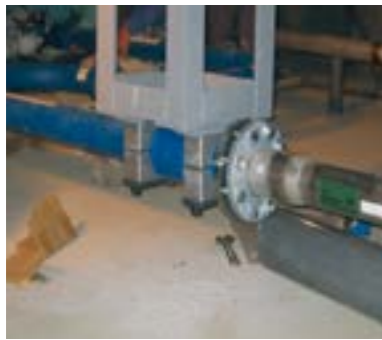
固定架台（建物側）
