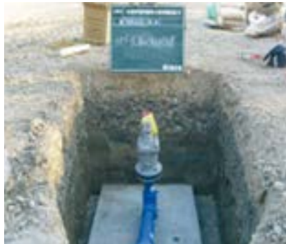
埋設消火配管
