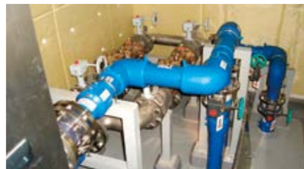
増圧ポンプ廻り
