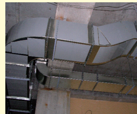
空調・ダクト: ダクトや機器の振動による騒音を低減します。
