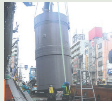
横浜市 (神奈川処理区六角橋雨水幹線) 呼び径: φ2600 落差: 27.2m
