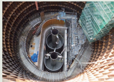
名古屋市 (中村中部雨水幹線) 呼び径: φ3000×2基 落差: 23.2m
