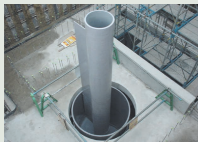
福岡市 (花畑第12雨水幹線) 呼び径: φ1650 落差: 9.4m
