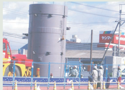
滋賀県 (守山栗東雨水幹線) 呼び径: φ2800 落差: 14.3m
