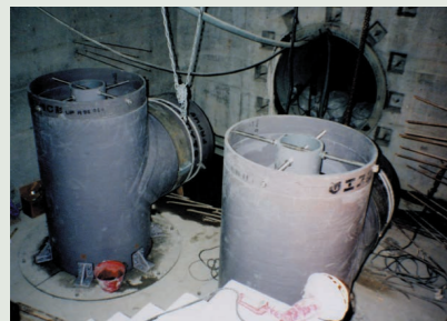
長野県 (千曲川流域) 呼び径: φ800 落差: 7.7m
