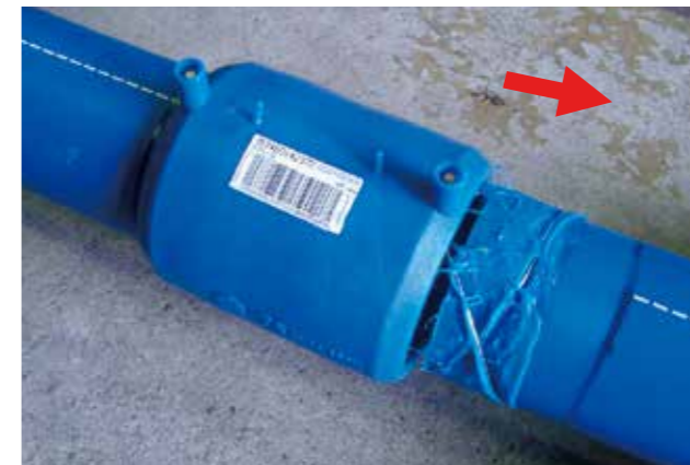
冷却完了前に管を引っ張り、 抜けが発生
