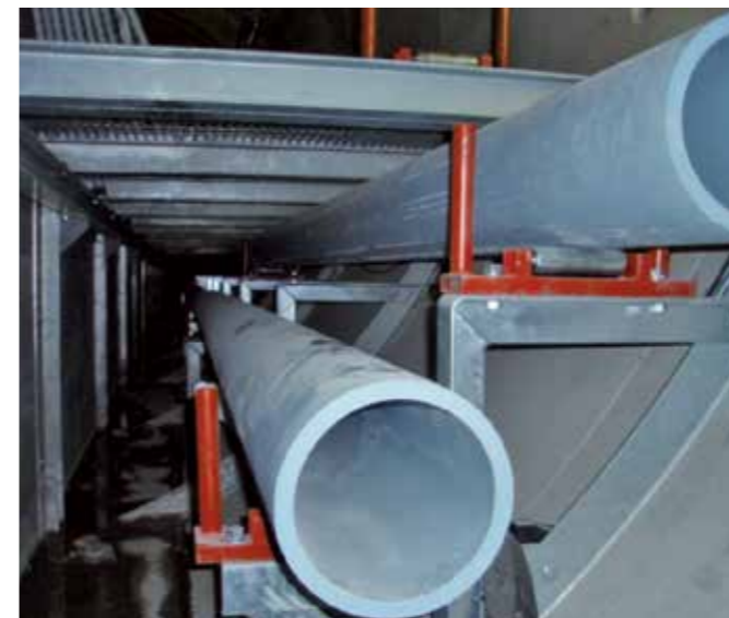
処理場連絡管路 (汚泥管路)
