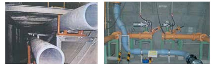
シールド内に設置された汚泥圧送管 処理場施設内に設置された汚泥配管
