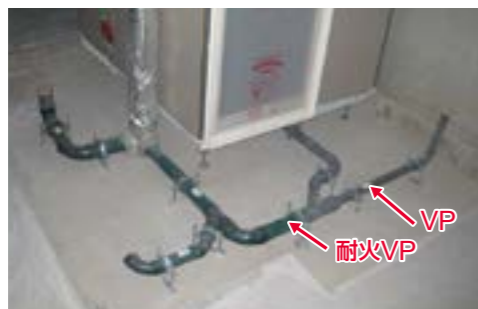
■部屋内の排水横枝管(区画から1m以降はVPに切り替え)
