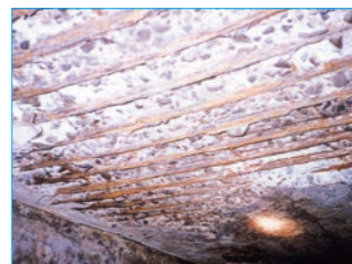
● 既設管の腐食状況(矩形)
