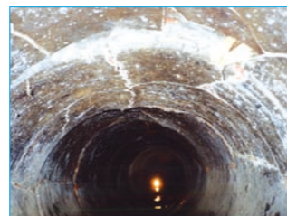
● 既設管のクラック発生状況
