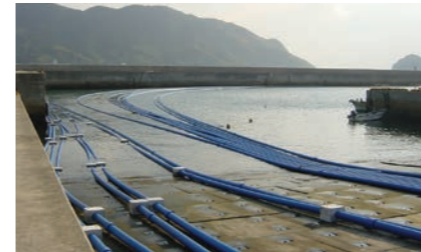
海洋深層水取水(海底配管)
