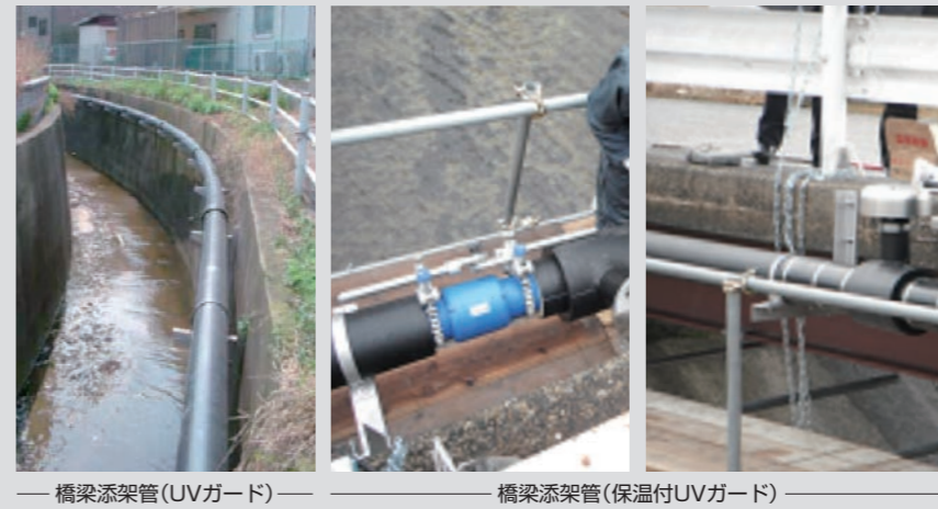
橋梁添架管(UVガード)
