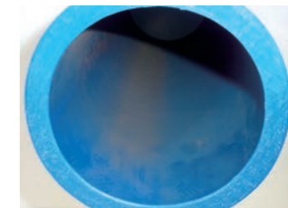
19年間使用した管の内面
