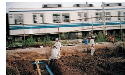
鉄道付近の配管(電食対策)
