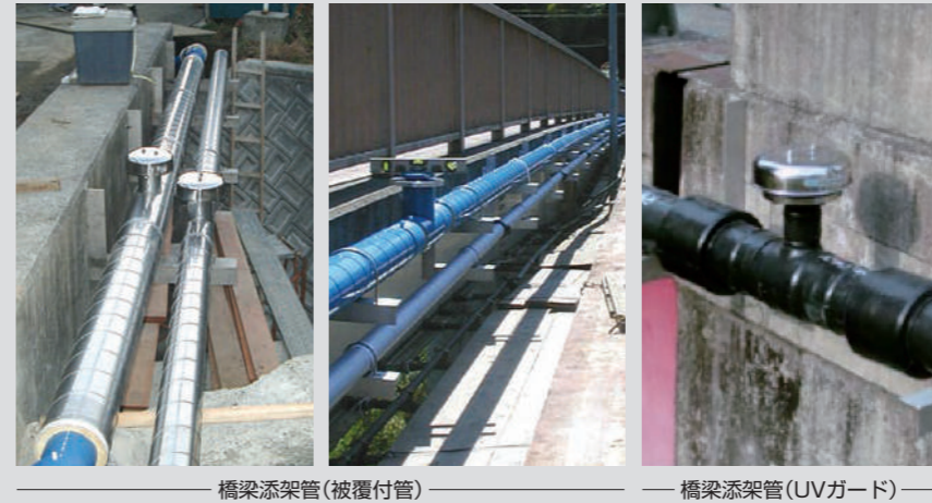
橋梁添架管(被覆付管)
