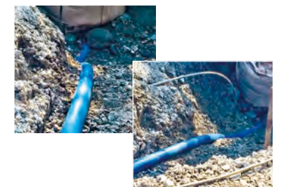
S字型に屈曲追従している配小PE管
