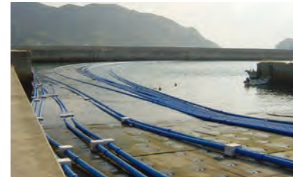
海洋深層水取水(海底配管)
