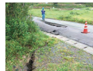
舗装面の損傷状況(砥川地区)
