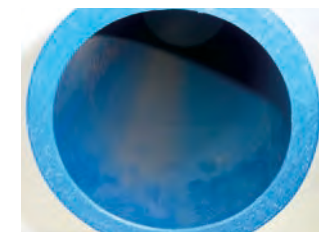
19年間使用した管の内面
