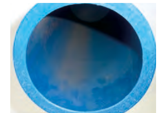
19年間使用した管の内面
