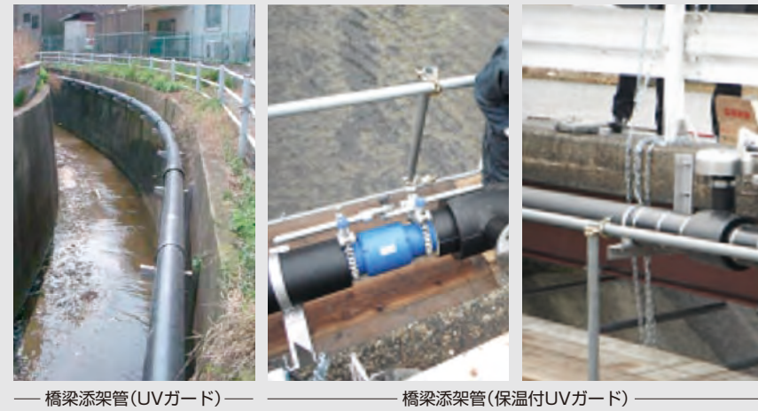
橋梁添架管(UVガード)
