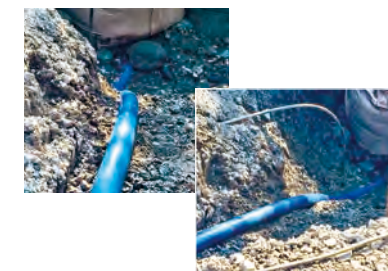
S字型に屈曲追従している配小PE管
