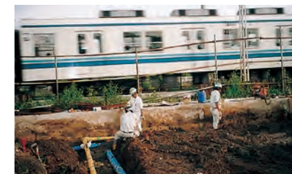
鉄道付近の配管(電食対策)
