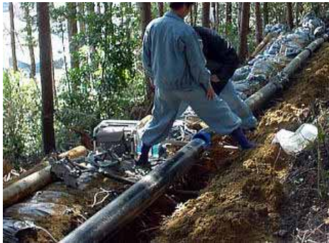
[ 事例1 ] 山間傾斜地での施工 エコハイパー JW150A の施工状況。 150 - 5m の管重量は、約 50kg / 本。 重機が侵入できない山間部でも、人力で小運搬 出来ます。
