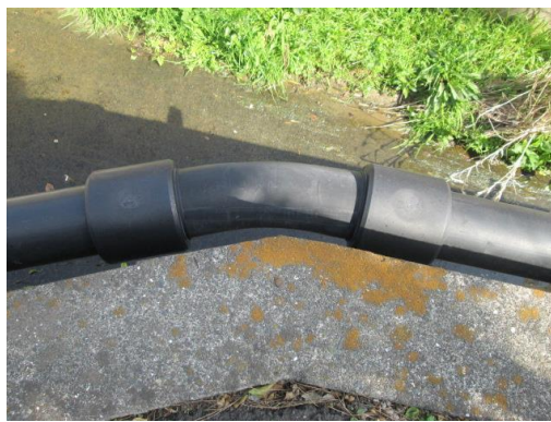
曲管及び接合部（12年経過後）
