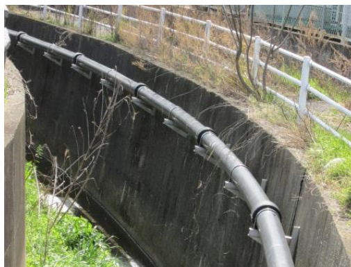
曲げ配管部（12年経過後）
