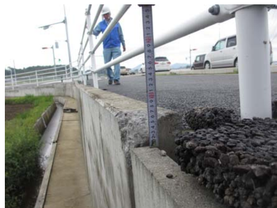
図2 御船町布設箇所(地盤変状)
