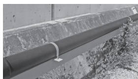
工場配管の露出部
