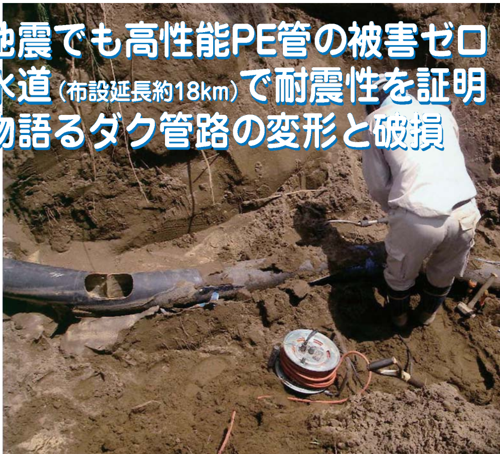
新潟県中越沖地震で変形破損したダクタイル鋳鉄管（刈羽村送水管の被害写真）
